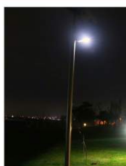
夜間のLED設置状況
